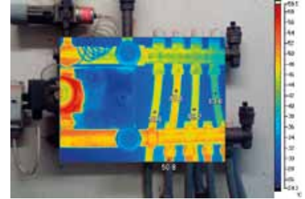
Manifold med trimmeskruer skal i modsætning til billedet indreguleres så temperaturen er ens på alle kredse.
