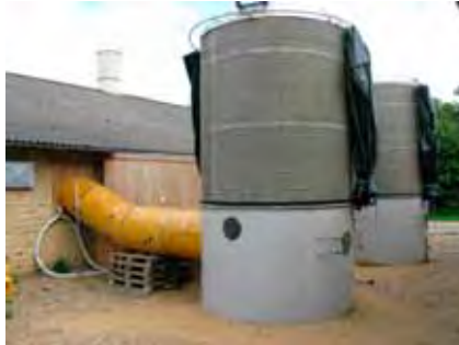
Luftrensningsmoduler med Leca® som filtermateriale.
