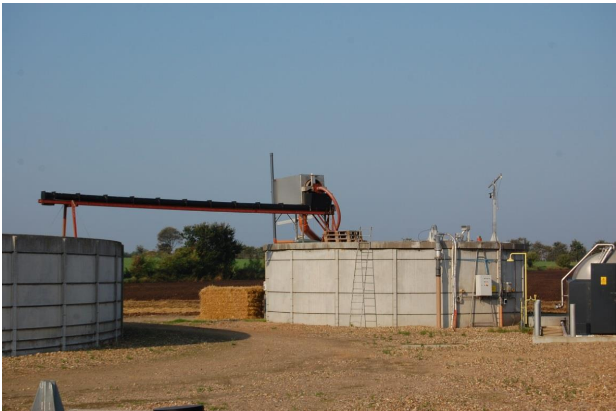
Figur 5. Gylletank og forsuringsanlæg i besætning B. Til højre i billedet ses syretanken, midt for processtanken med tromlesien placeret ovenpå, og en snegl der fører fiberdelen fra tromlesien til gylletanken.
