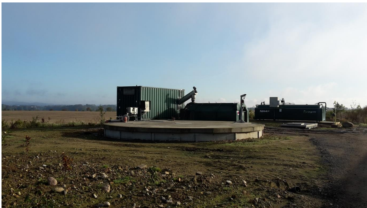
Figur 2. Behandlingsanlægget med syretank i baggrunden og processtank forrest. Separatoren var placeret i containeren til venstre. Containeren til opsamling af fiberfraktionen (i midten) blev tømt to til tre gange om ugen.
