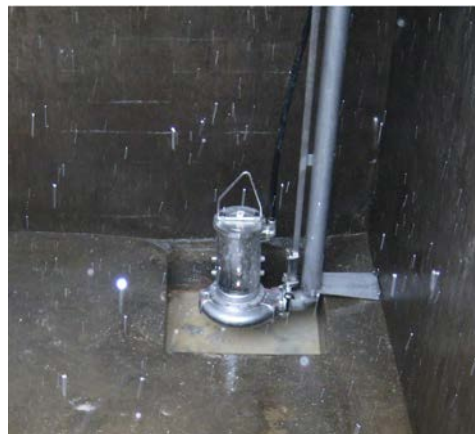
Foto 1.32 Rustfri pumpe i påslag til våd opblending.
