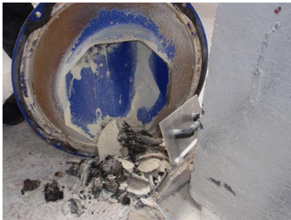
Foto 2.5 Meget hårde belægninger i tilførselsrør til mølle. Det vurderes, at der ikke var risiko for, at de løsne sig af sig selv.
