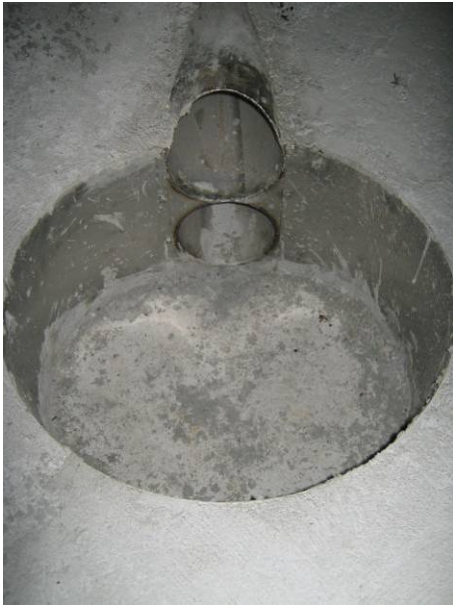
Foto 1.2 Silohaake under etablering: To stålør bygges ind til en fordybning i silobunden, hvorfra majsens snegles ud af siloen.
