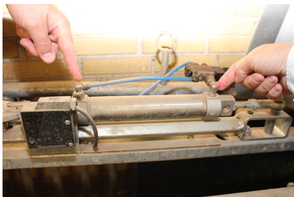
Figur 9. Justering af indgangslågens åbne- og lukkehastighed justeres på et stempel (fingrene peger). Endvidere ses sensoren (lille sort boks) der registrerer hvornår der kommer en so ind i stationen. Denne kan på nogle fabrikater vinkles/flyttes.
