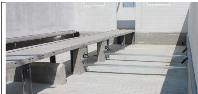
Figur 1. Vejeceller i gyllekanal før montering af gødningsopsamlingsbakke.
