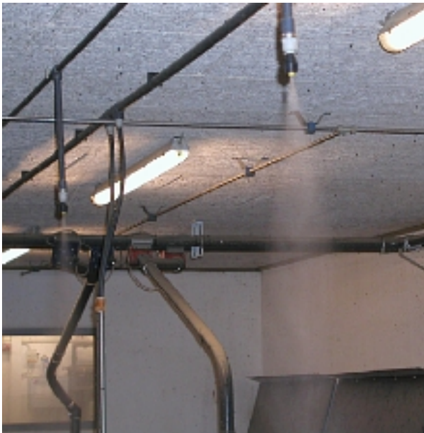
Foto: Overbrusningsanlæg hvor dyserne er rettet lodret ned i stien (billededatabase nr. 6264)
