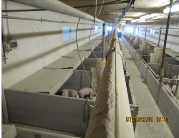
Figur 1. EPI-system monteret i smågrisestald.
