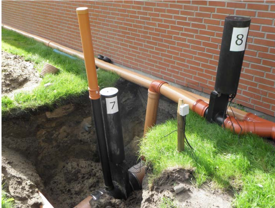
Figur 3. Ved etablering af forsyningsanlægget blev gyllesystemet ændret og automatiseret ved dels en skydeventil på 315 mm gyllerør, dels en skydeventil på 110 mm rør, der blev brugt til at pumpe behandlet og forsuret gylle retur til stalden.
