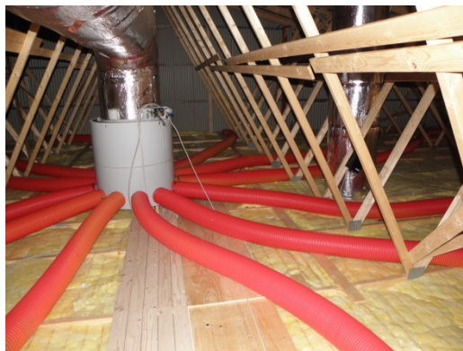
Figur 3. Luften fra punktudsugningsanlægget blev samlet i en samlebrønd på loftet.
