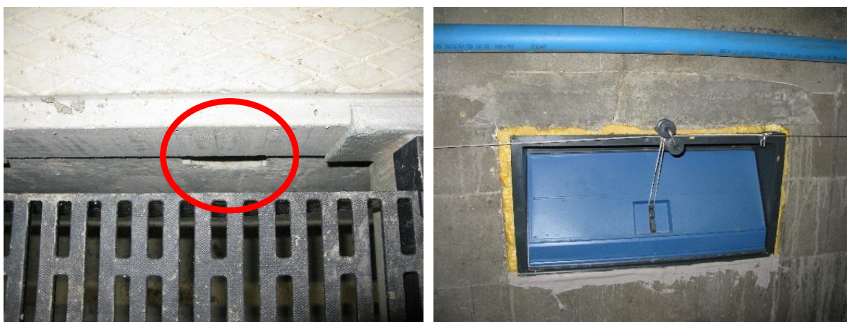
Figur 2. Billede til venstre: Sugepunkt placeret ved bagkanten af farestien og midtergangen (markeret med rød cirkel). Sugepunkterne målte 7,0 cm x 8,5 cm og med en afstand på 1,40 meter mellem hvert sugepunkt. Billede til højre: Imellem hver sidekanal og hovedkanal var der placeret en DA 1200 vægventil (58 til 59 cm bred), som kunne lukkes, når sektionen var tom under rengøring.
