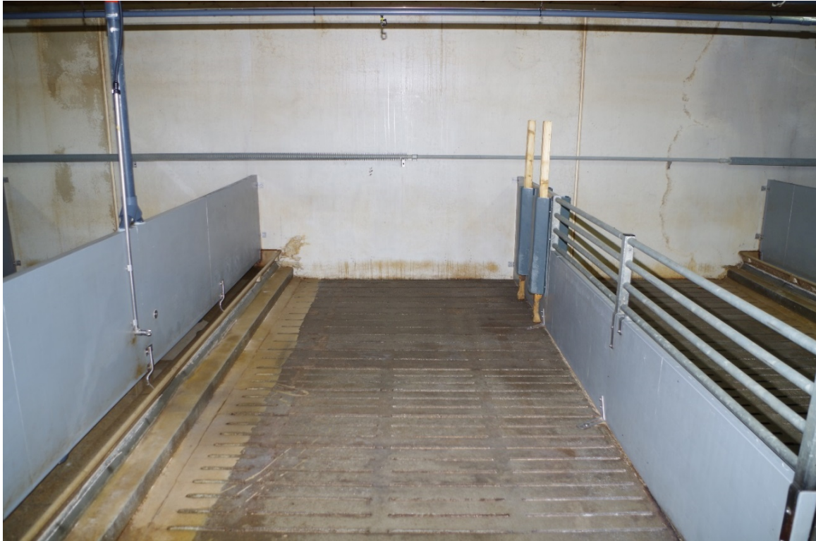
Figur 2: Indretning af stierne i afprøvningsbesætningen. Varmeforsyningen skete via 1" ribberør på sektionsvæggen.
