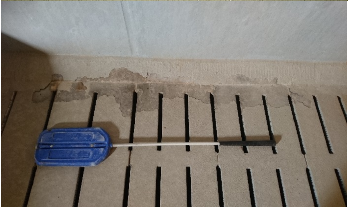
Figur 13: Øverst: Epoxybrud ved kontakt mellem to spalter. Nederst: Større epoxybrud langs væg.
