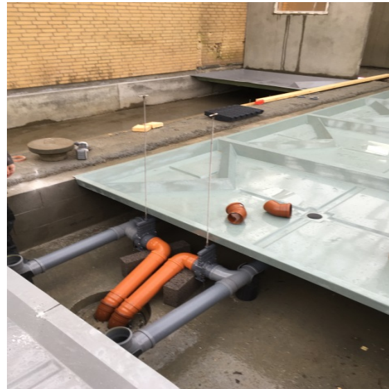
Figur 5. Rør forbundet til gyllekanal. Der er etableret en spadeventil per rørstreng.
