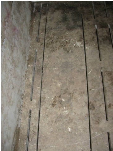
Figur 2. Fastgulvselement hen over Ø400 røret for at undgå urin og gødning i sugepunktet.
