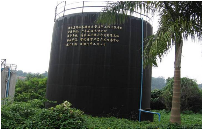
Biogasreaktortank, hvor gyllen afgasses og udrådnes.
