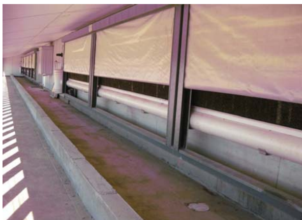
Foto 13. I forbindelse med luftindtaget i stalden til søer etableres der filtre i forbindelse med forebyggelse af PRRS (filtre monteres på rækken af funda-blokke til venstre i billedet).
