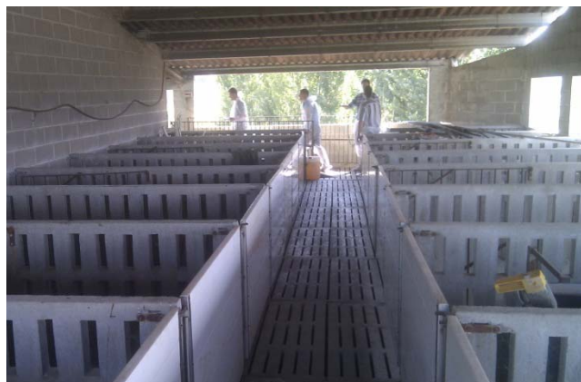
Udlevering med naturlig ventilation
