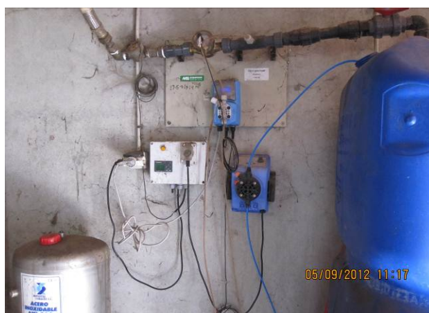
Drikkevandet renses og tilsættes syre ved indgang til smågrisestalden.
