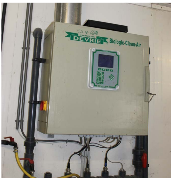
Foto 19. Styringskab til biologisk luftrensner.
