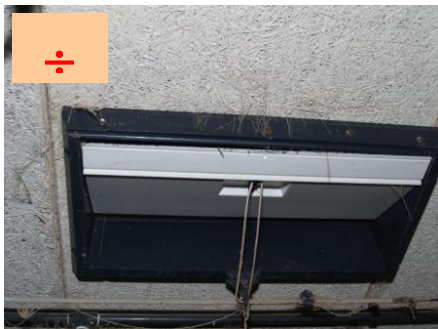
Pkt. 3 Loftventilen lukker ikke tæt
