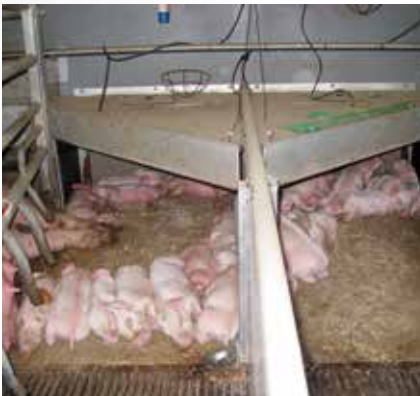
Aniheater sidder under overdækningen (tv). e-Heat (th) sidder i overdækningen.
