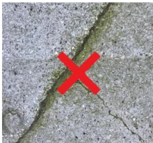
Billede af revnet og ikke tæt beton.
