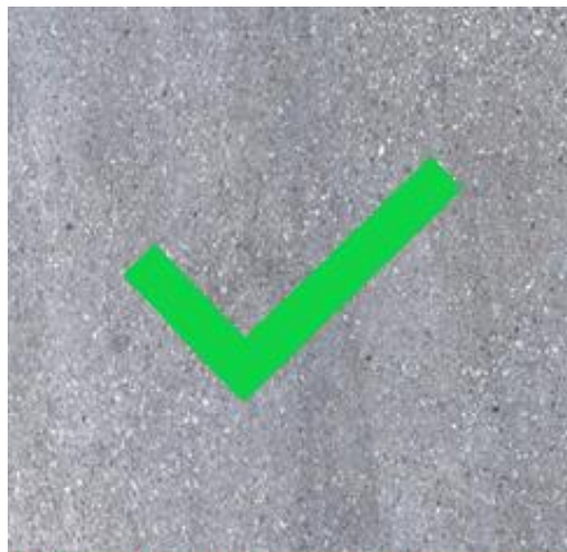
Billede af tæt betonbund uden revner.
