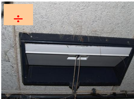
Pkt. 3 Loftventilen lukker ikke tæt
