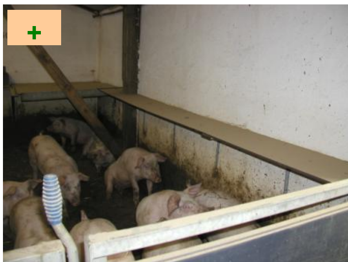
Pkt. 5. Prelleplade på væg
