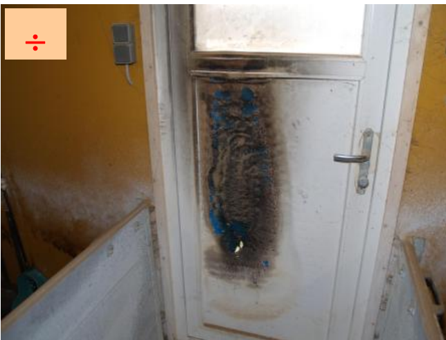
Varmekanon for tæt på dør
