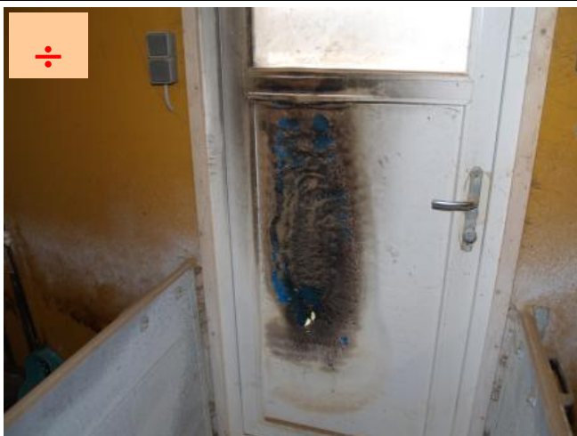
Varmekanon for tæt på dør
