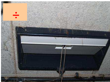
Pkt. 3 Loftventilen lukker ikke tæt
