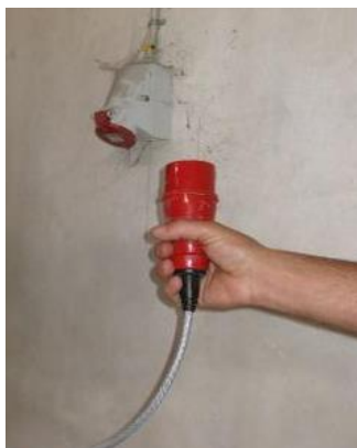
Træk stikket, når enheden rengøres. Der skal være et stik på alle anlæg.
