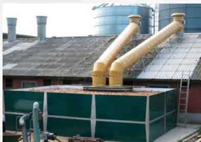
BIOREX-Hartmann biofilteret etableret ved en slagtesvinestald.
