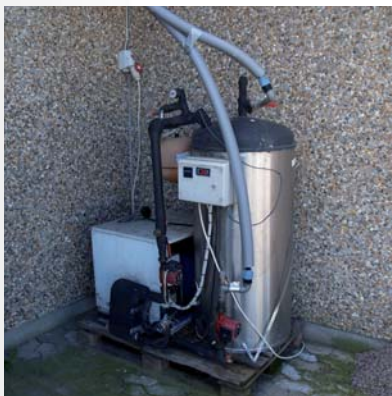
7 kW køleanlæg til gulvkøling.
