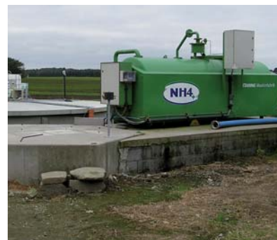
Bag ved forsøringsanlægget ses procestanken og ovenpå den en palletank, der indeholder en 30 % opløsning af brintoverilte.
