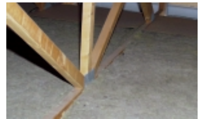
Et undertag af masonit er tilstrækkelig isolering til at reducere solindstrålingens opvarmning af den indtagne luft.
