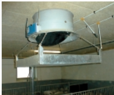
Reduktion af støj fra ventilatoren sker ved hjælp af en støjreducerende plade under ventilationsskorstenen.
